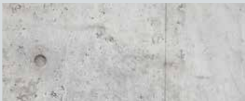
Nieuw beton met geringe onvolkomenheden
